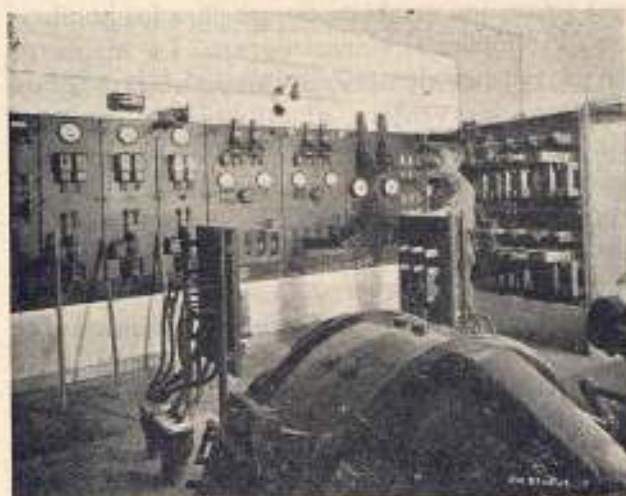
Figura 6.—Cabina eléctrica en los estudios «Pathé-De Mille» de Culver-City.
